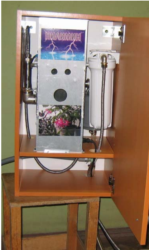
Внешний вид генератора, смонтированного в кухонном шкафу
